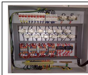
Quadro das Bombas (antes)
