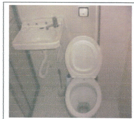
Foto 16 – Banheiro – Vaso e Lavatório
